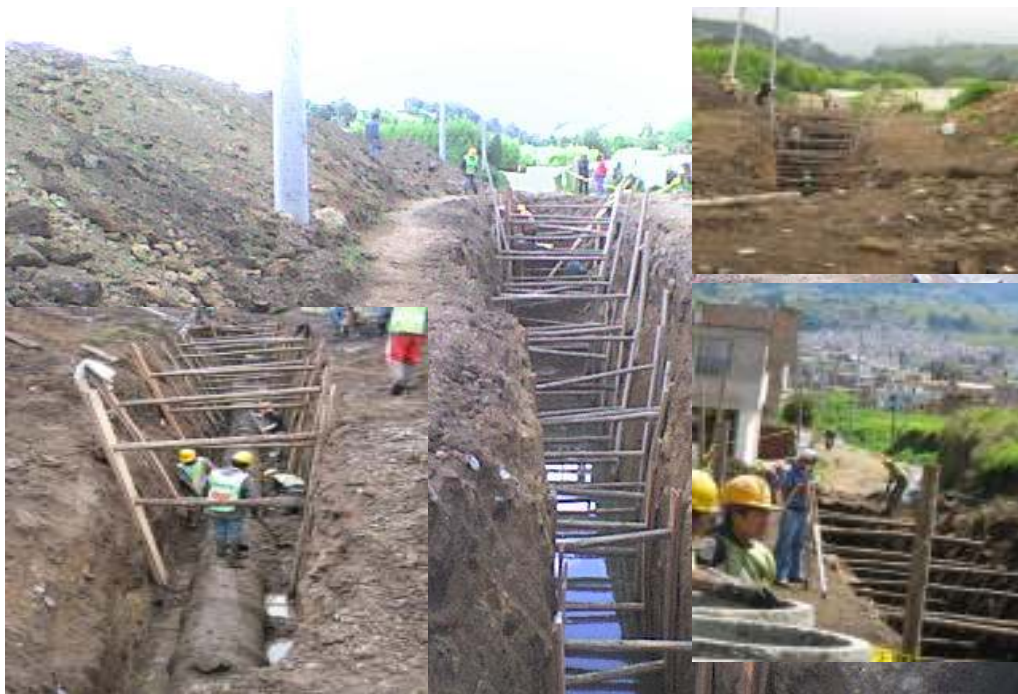
Figura No. 10. Bombeo de aguas combinadas filtradas hasta la excavación por cámara de inspección en mal estado
