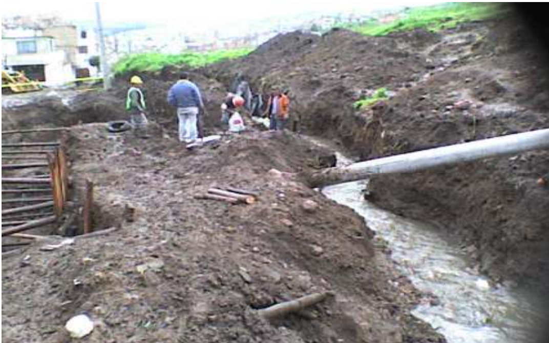
Figura No. 8. Personal de Empopasto intentando destapar la tubería taponada tramo Cra 13 entre calles 1a y 1b.
