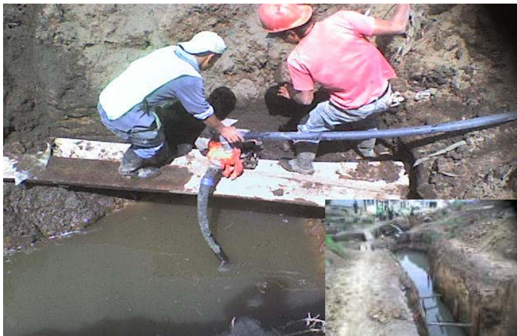
Figura No. 11. Instalación de triturado como cama de cimentación y tubería de concreto diámetro= 24"
