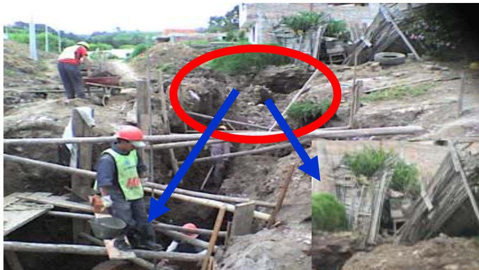
Figura No. 4. Taponamiento de la tubería de alcantarillado combinado existente en concreto diámetro = 24"
