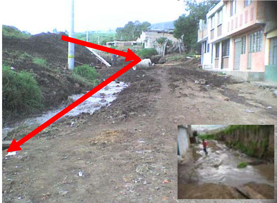
Figura No. 3. Derrumbe de talud y cerramiento en guadua vivienda del señor Raul Morales Cra 13 calle 1a 1305
