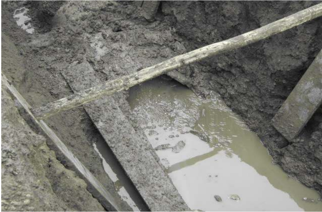
Figura No. 5. Polideportivo Barrio Caicedo bajo lleno de material arrastrado por las aguas combinadas que se desbordaron por el taponamiento de la tubería
